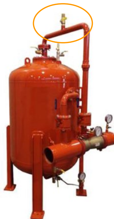
Rys. 3 Zbiornik przeponowy z automatycznym zaworem na przewodzie pianowym
